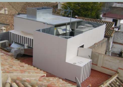
Caseta y barrera acústica con silenciadores
