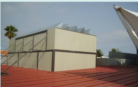
Cabina acústica con viseras en cubierta
