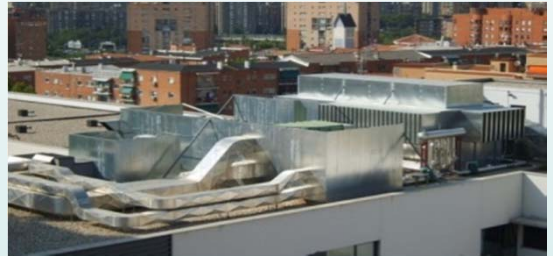
Barrera/caseta acústica y silenciadores en cubierta
