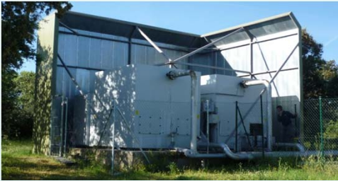
Apantallamiento acústico con viseras
